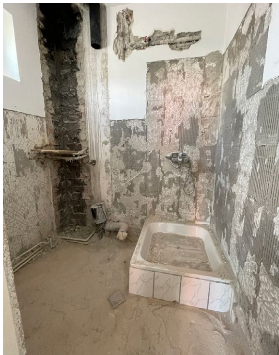
Der Vortrupp hat mit den rumänischen Jugendlichen bereits Vorarbeit geleistet und die Abbrucharbeiten übernommen.
